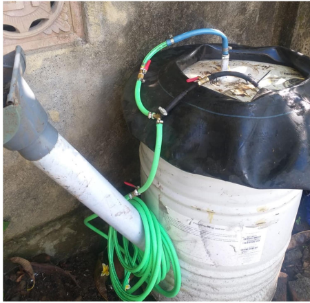
Gambar 1a instalasi biogas yang dibuat
