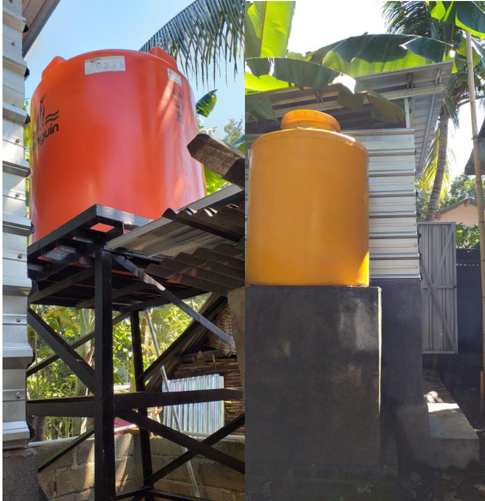
Gambar 2. Tandon penampung air untuk wudhu dan kamar kecil
