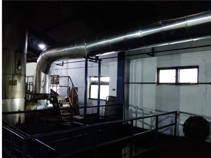
Gambar 2. Pipa bypass exhaust pada sistem gas buang PLTD Paokmotong
