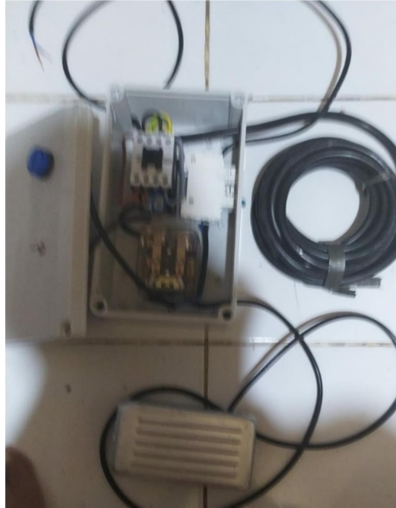
Gambar 2 Kontrol arah putaran motor listrik yang sudah terangkai
